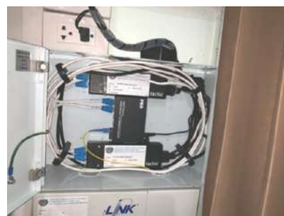
กล่องเก็บแผงกระจายสัญญาณ สาย Fiber Optic และอุปกรณ์ PoE
