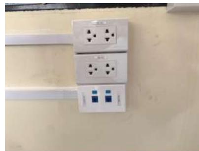
จุดติดตั้งสายสัญญาณ (LAN)
