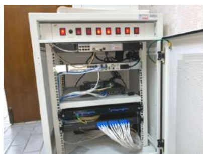
อุปกรณ์กระจายสัญญาณและแผงกระจายสัญญาณ สาย Fiber Optic Injector
